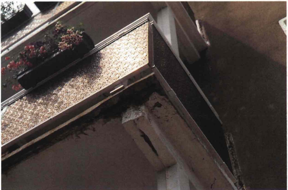
Korrosionsschäden an der Balkonplatte
