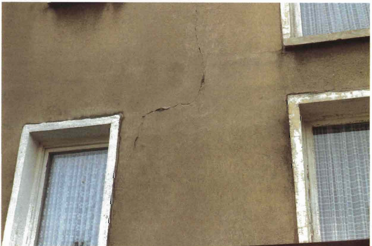
Deutliche Rißbilder im Putz
